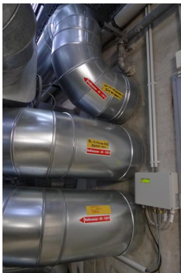
Misura di energia termica sulle condotte di condizionamento aria.
